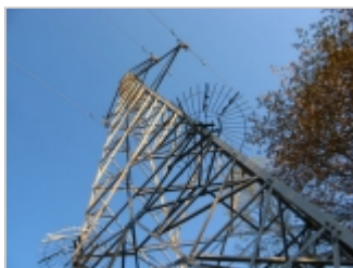
2つ目の送電鉄塔
